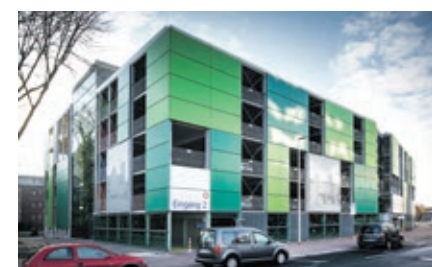
Fortschrittlich unterwegs: Im City-Parkhaus wurde ein neuer Schaltschrank für die Aufladung von Elektroautos aufgebaut.
